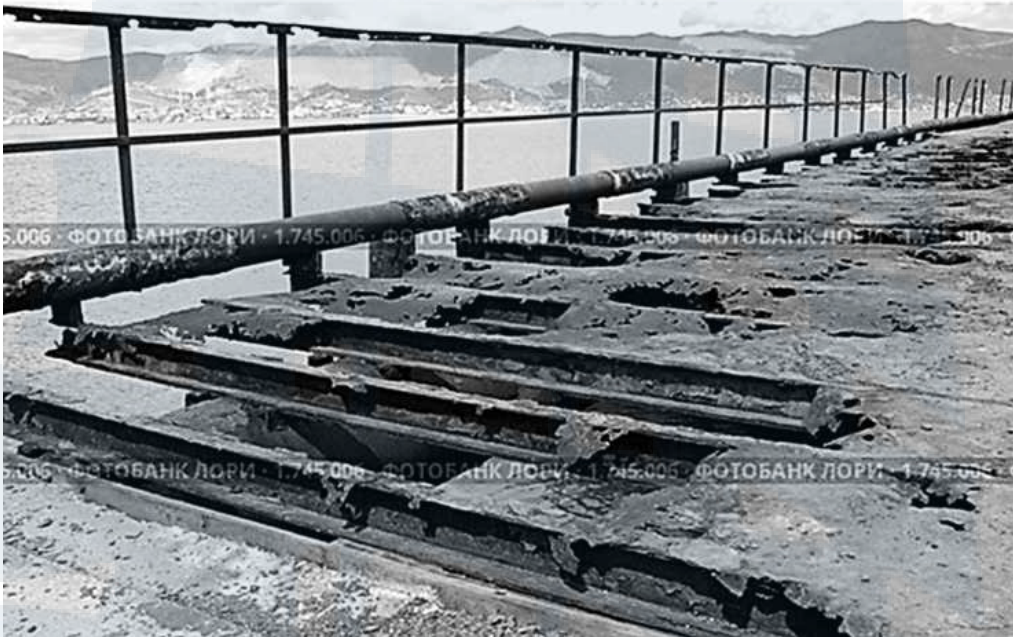
Рис. 29. Коррозия металлических конструкций причала
