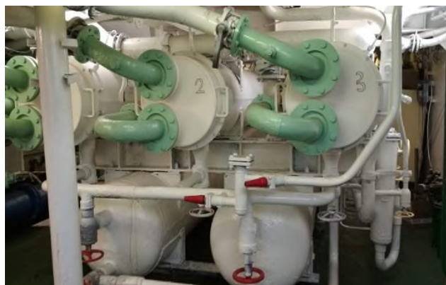
Рисунок 64. Фотография конденсаторов и линейных ресиверов.
