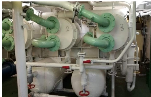
Рисунок 64. Фотография конденсаторов и линейных ресиверов.
