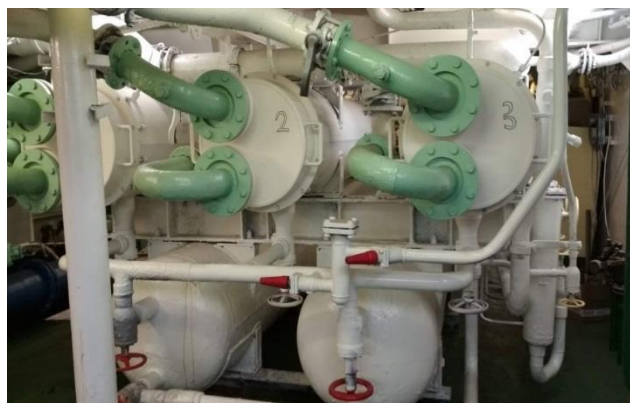
Рисунок 64. Фотография конденсаторов и линейных ресиверов.
