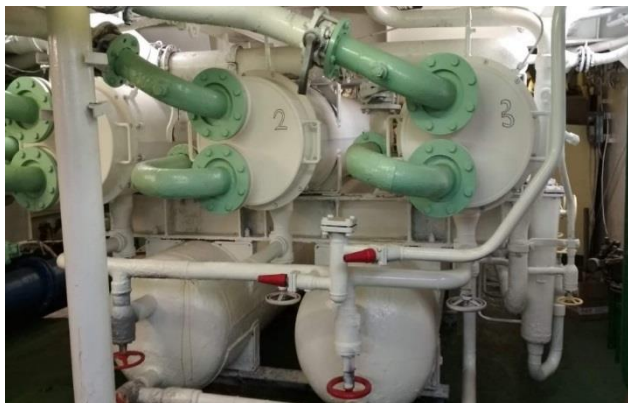
Рисунок 64. Фотография конденсаторов и линейных ресиверов.
