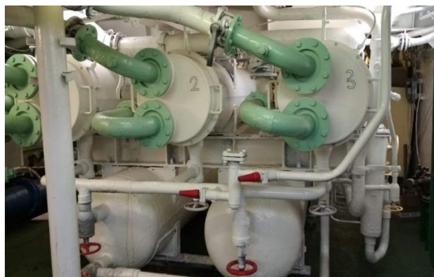
Рисунок 64. Фотография конденсаторов и линейных ресиверов.
